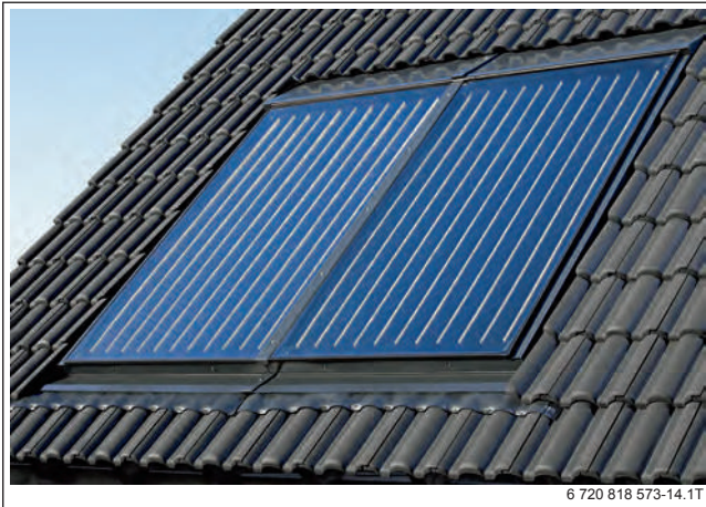
Bild 221 Gesamtansicht Kollektorfeld mit Logasol SKN4.0-s Indach
